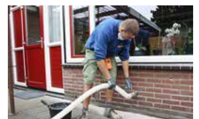
Isolatie van uw woning betekent direct energie besparen
